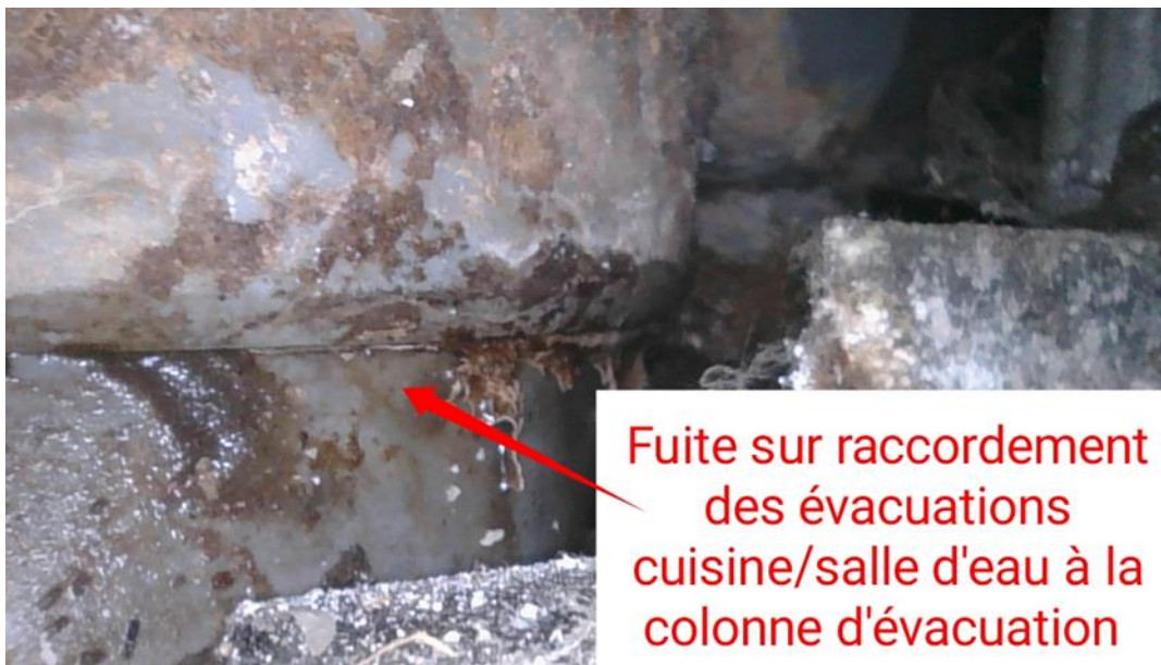
Fuite localisée sur le branchement des évacuations cuisine/salle d'eau sur la colonne d'évacuation collective.
